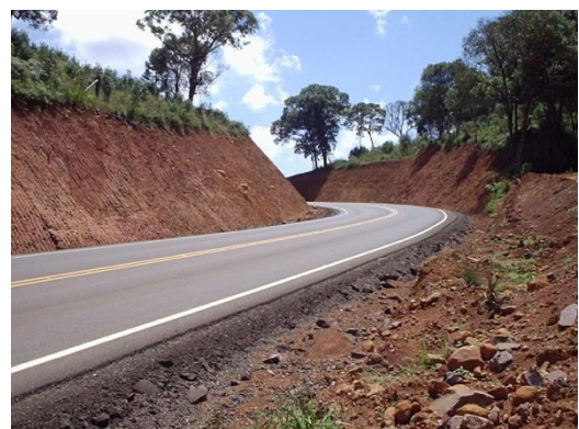
Figura 4: Taludes desprovidos de cobertura vegetal, efeito erosivo e possibilidade de desmoronamento; Fonte: Borszowskei, P., R., (2008).
