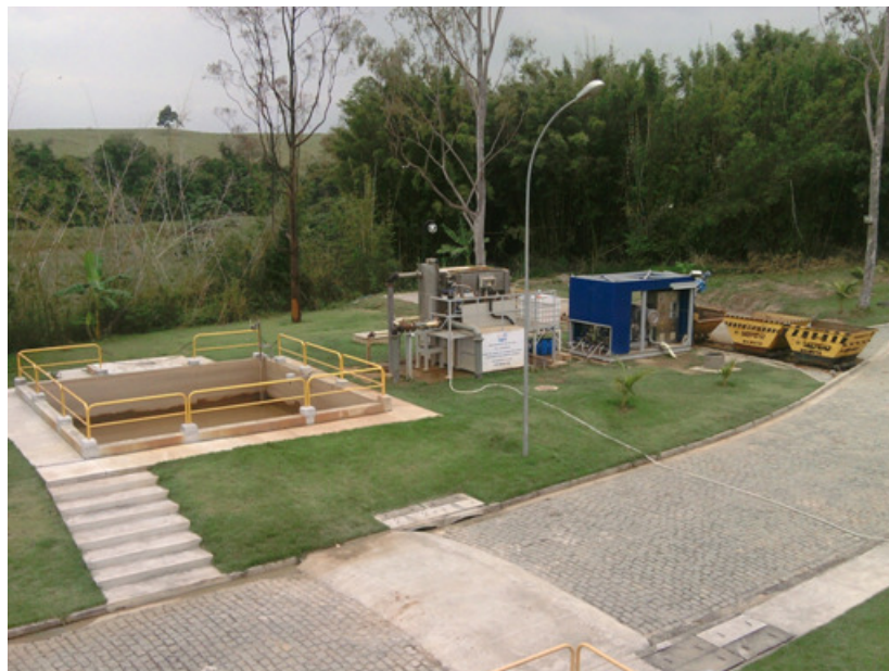
Figura 3: Sistema de desidratação implantado – Skid da empresa Pieralisi
